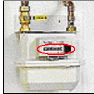
Comptador de gas natural
