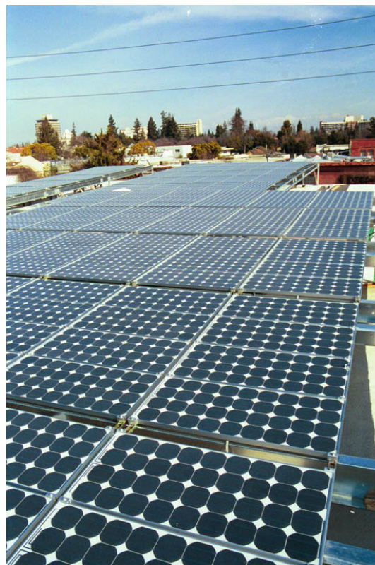
Instalación de generación de electricidad mediante tecnología solar fotovoltaica sobre cubierta..
